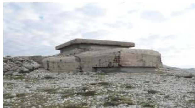
Poste de direction de tir allemand de Brigantin après mise en sécurité
